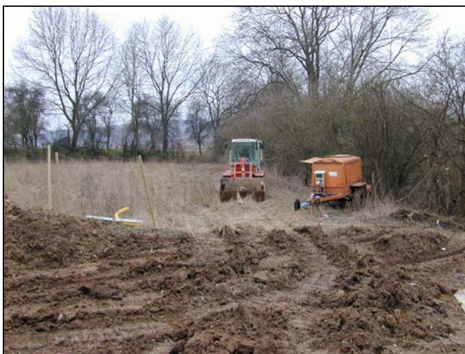
Unerlaubtes Öffnen von Schutzzäunen und Abstellen von Baumaschinen auf einer gewässernahen Ruderalfläche
